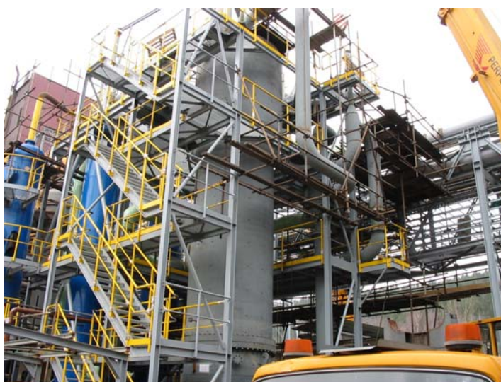
Obr. 16 Instalace souboru výměníků chlazení generátorového plynu
