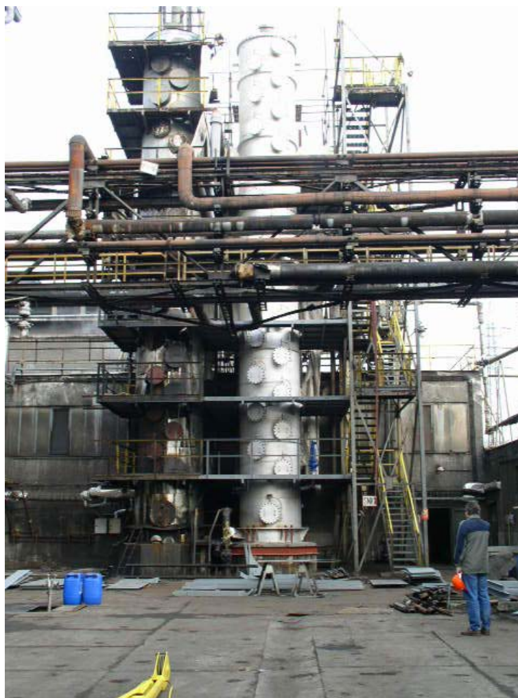
Obr. 9 Instalace odháněče benzolu, Koksovna Svoboda, Ostrava
