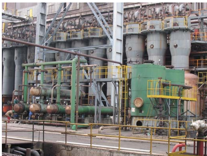
Obr. 1 – Jednotka parních utilizačních kotlů pro chlazení generátorového plynu
