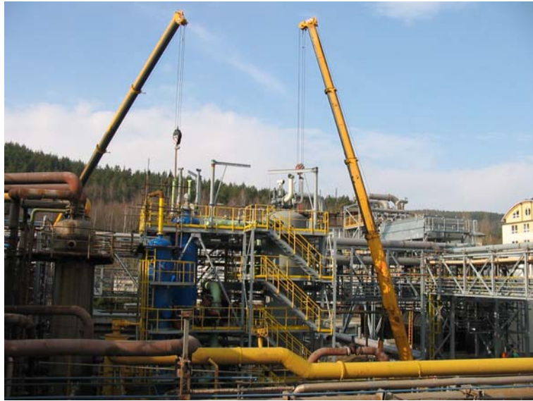
Obr. 8 Foto z instalace provozního souboru utilizace tepla z hořákového generátoru
